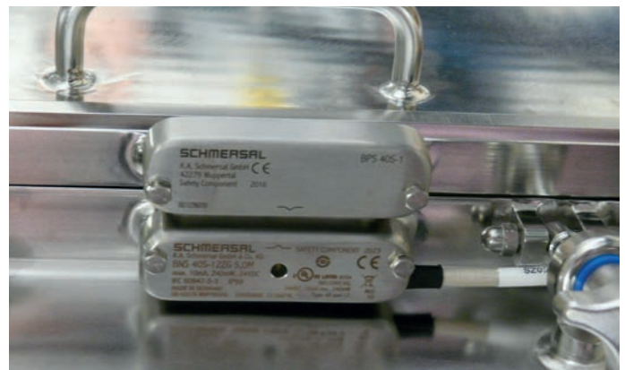
02 Je nach Anwendung – hier an einer Anlage für die Pharmaproduktion – werden auch nicht verdeckt montierte, codierte Sicherheitssensoren verwendet
