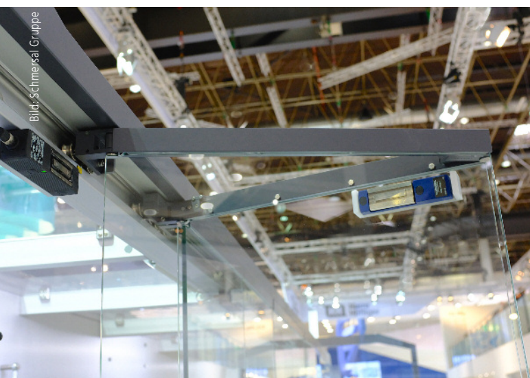
Die transparenten und rahmenlosen Schutztüren aus Glas werden durch elektromagnetische Sicherheitszuhaltungen von Schmersal vom Typ MZM 100-AS abgesichert.
