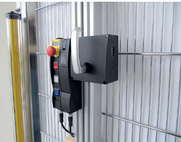
◀ Auch großräumige Robotikanlagen lassen sich mit den Systemen von Schmersal wirtschaftlich absichern, z. B. mit dem Bedienfeld BDF200 in Kombination mit der Türzuhaltung AZM201
